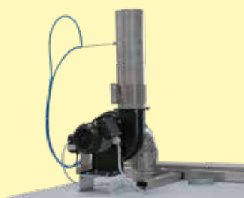
Ouverture d'arrivée d'air et puissant ventilateur d'évacuation d'air installés sur le four
